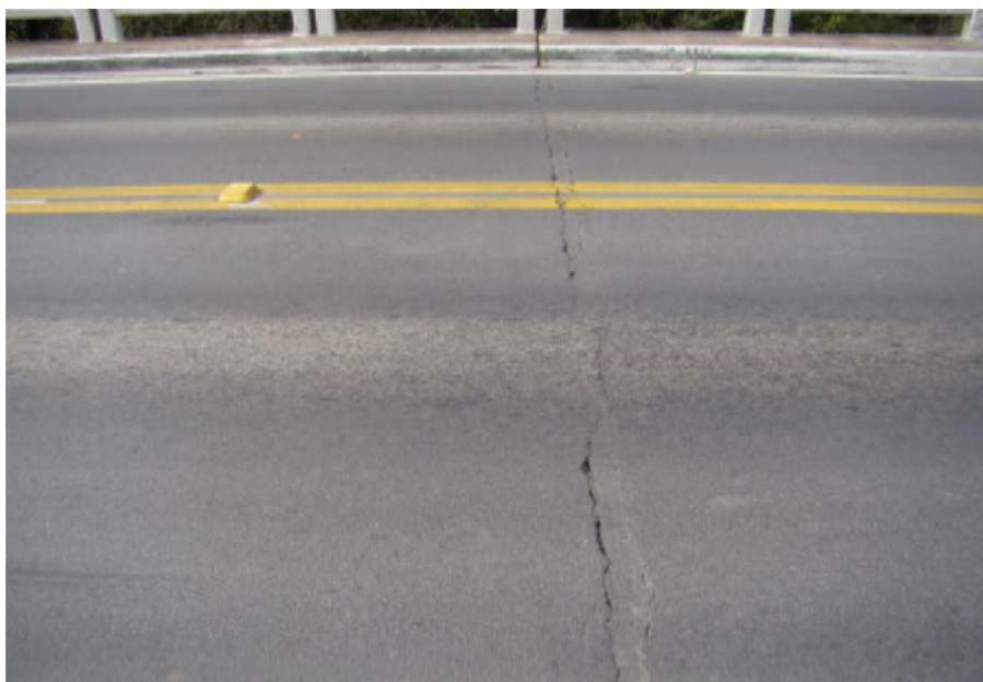
Foto 31 – Detalhe juntas de dilatação obstruídas – Encontro lado Camaquã.
