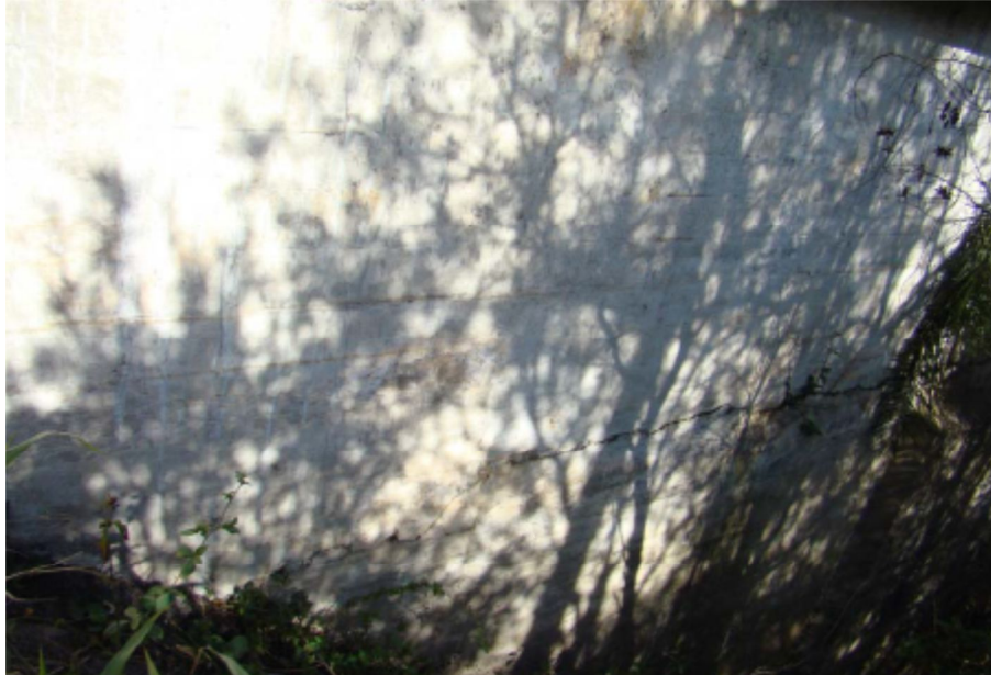
Foto 08 – Detalhe fratura na parede lateral do encontro – Lado Camaquã
