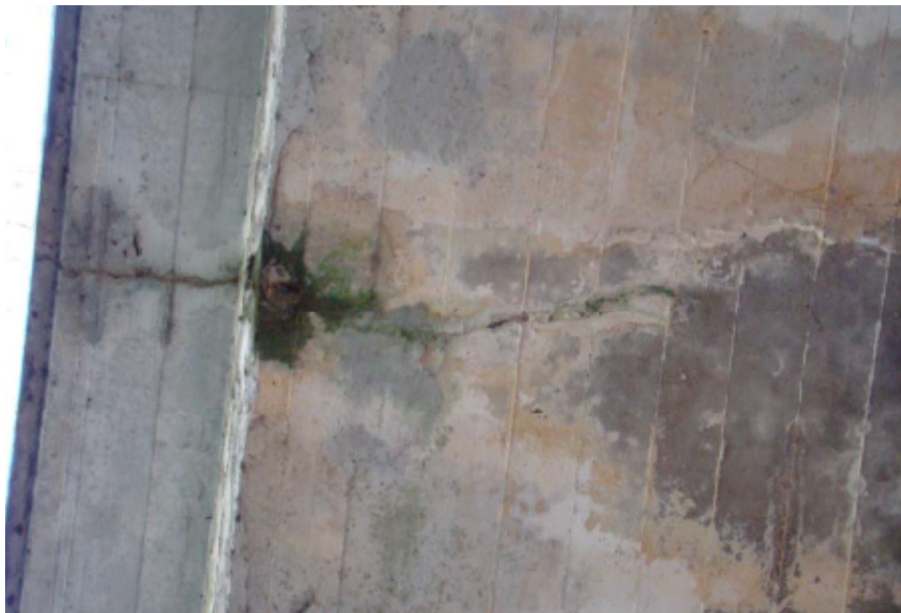
Foto 20 – Detalhe trincas nos balanços do passeio, próximo ao pilar P5
