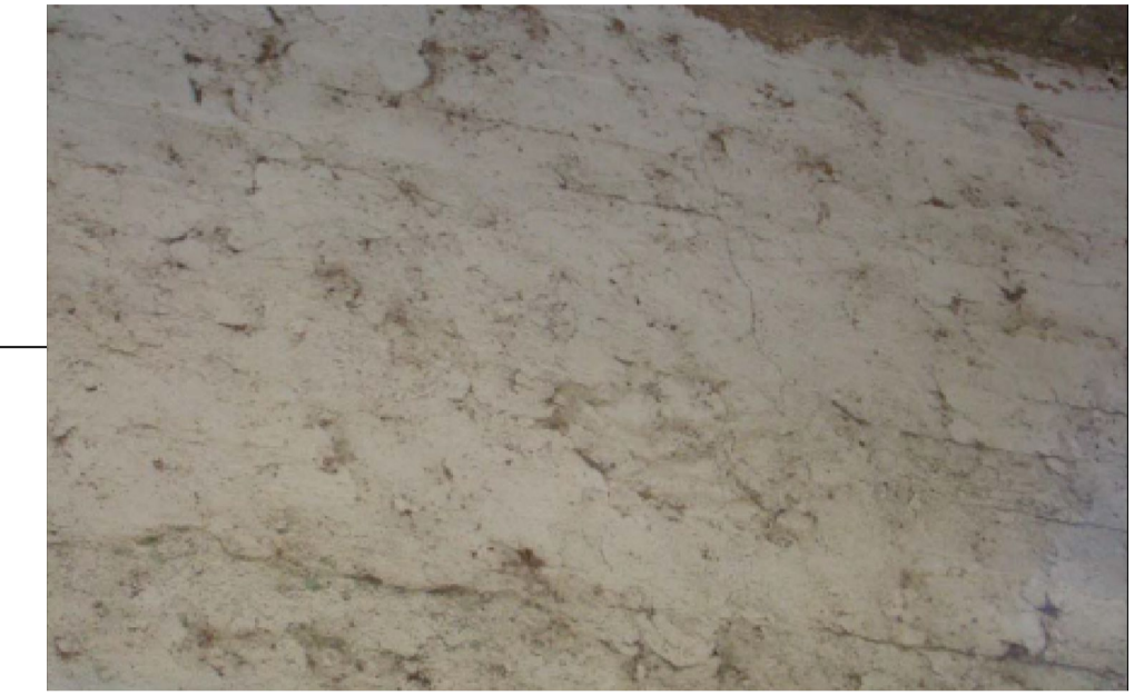
FISSURAS CARACTERISTICAS NAS TRANSVERSINAS
