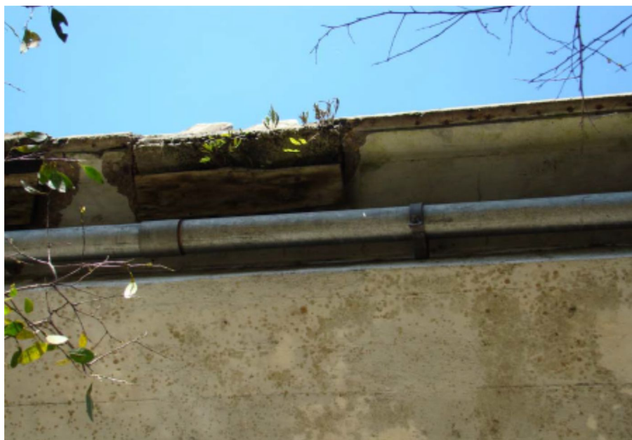
Foto 26 – Detalhe obstrução das pingadeiras
