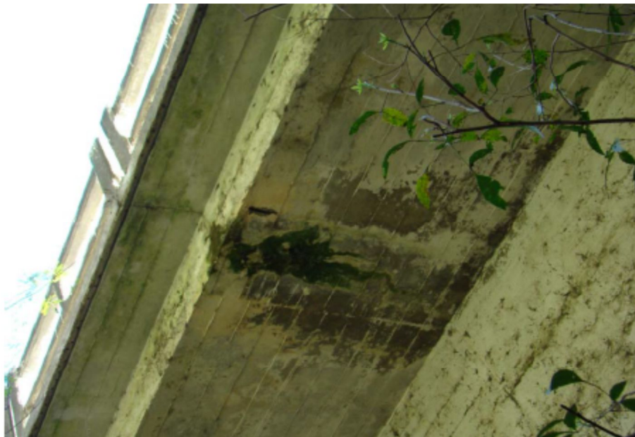
Foto 22 – Detalhe trincas nos balanços do passeio, próximo ao pilar P7
