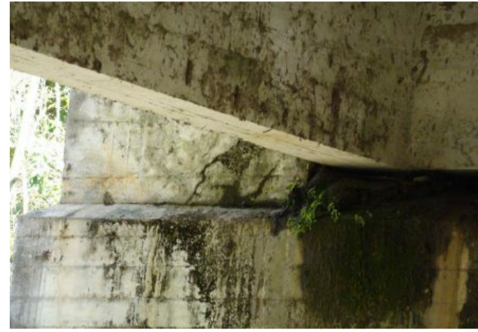
APARELHO DE APOIO OBSTRUIDO POR ENTULHOS - LADO ESQUERDO CAMAQUÃ
