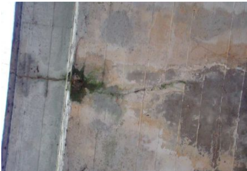
TRINCAS BALANÇOS DOS PASSEIOS NO ALINHAMENTO DO PORTICO P5 LADO ESQUERDO
