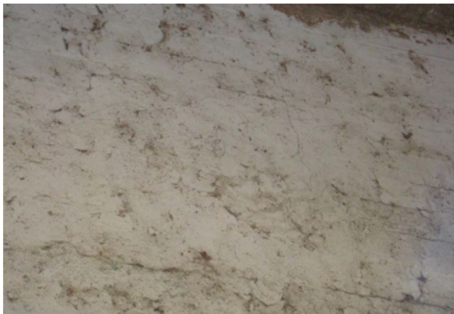
Foto 16 – Detalhe fissuras na primeira transversina entre pilar P7 e P8
