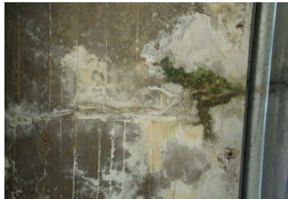
TRINCAS BALANÇOS DOS PASSEIOS NO ALINHAMENTO DO PORTICO P5 LADO DIREITO
