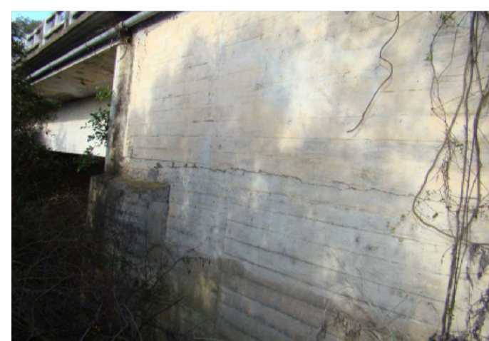
FRATURA NA PAREDE LATERAL DIREITA - LADO PELOTAS
