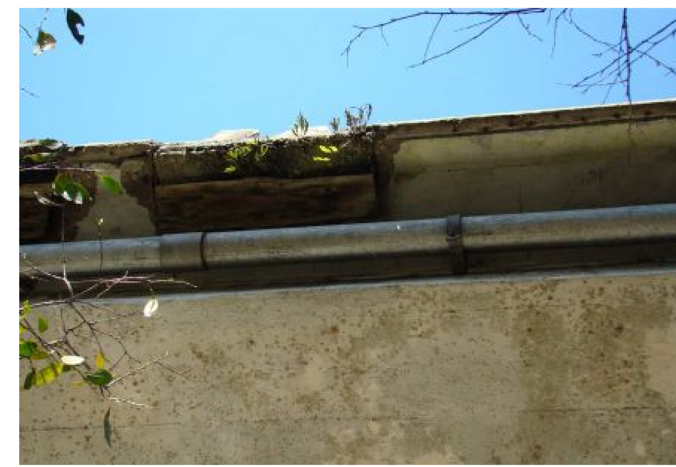
PINGADEIRAS OBSTRUIDAS POR SUBSTITUIÇÃO INADEQUADA DE GUARDA RODAS
