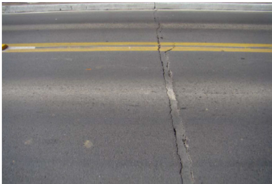
Foto 32 – Detalhe juntas de dilatação obstruídas – Encontro lado Pelotas.
