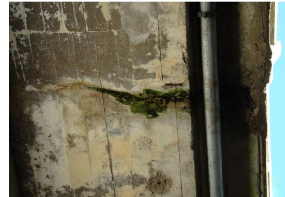
TRINCAS BALANÇOS DOS PASSEIOS NO ALINHAMENTO DO PORTICO P7 LADO DIREITO
