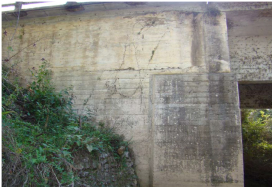
Foto 10 – Detalhe fratura na parede lateral do encontro – Lado Pelotas
