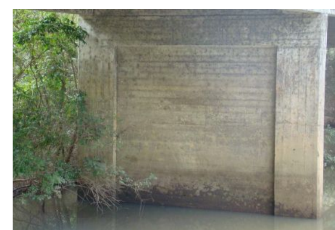
PILAR CORTINA EM BOAS CONDIÇÕES - P8 LADO PELOTAS
