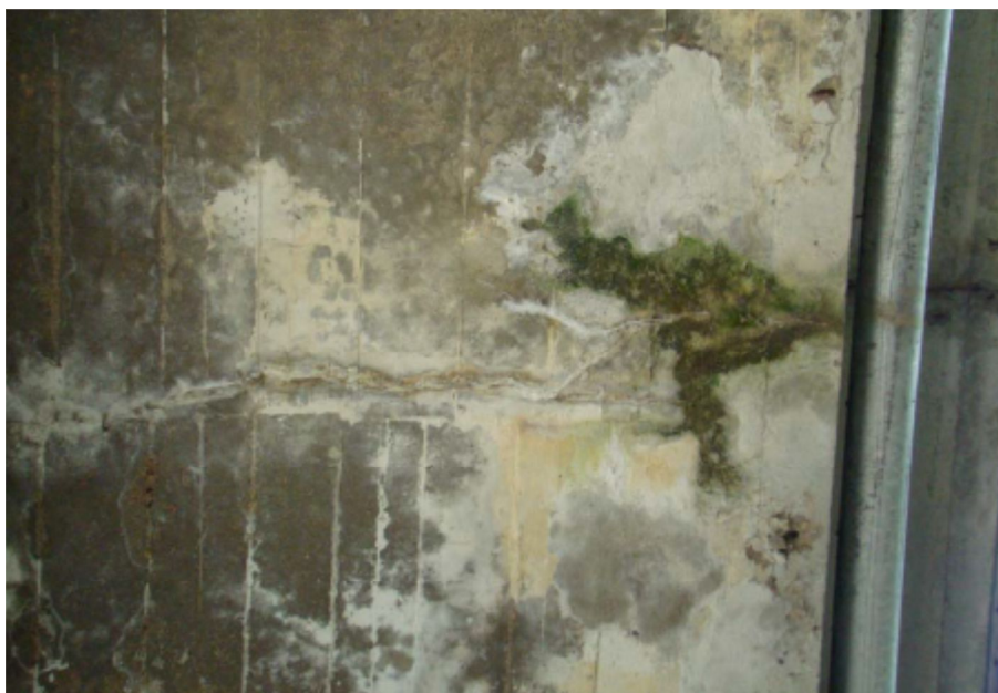
Foto 19 – Detalhe trincas nos balanços do passeio, próximo ao pilar P5
