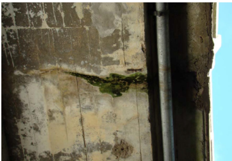
Foto 21 – Detalhe trincas nos balanços do passeio, próximo ao pilar P7
