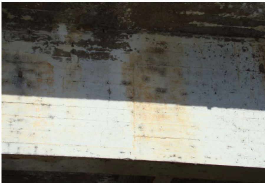
Foto 14 – Detalhe fissuras entre pilar P2 e P3
