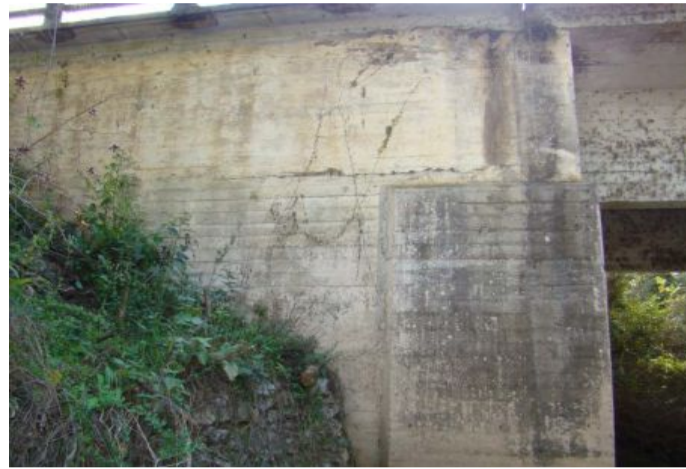
FRATURA NA PAREDE LATERAL ESQUERDA - LADO PELOTAS
