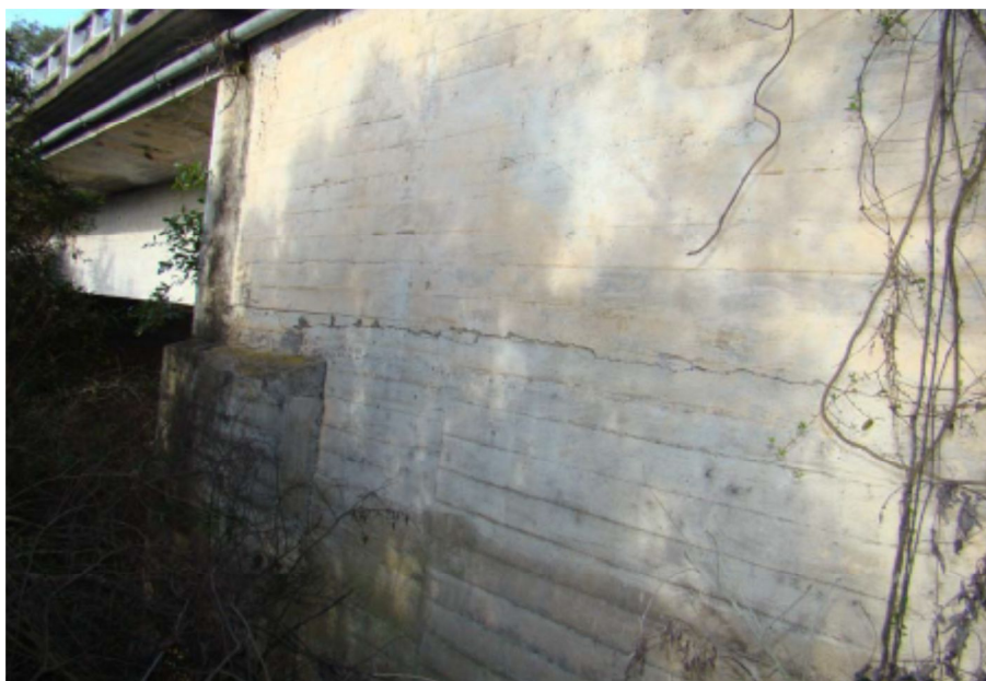
Foto 11 – Detalhe fratura na parede lateral do encontro – Lado Pelotas
