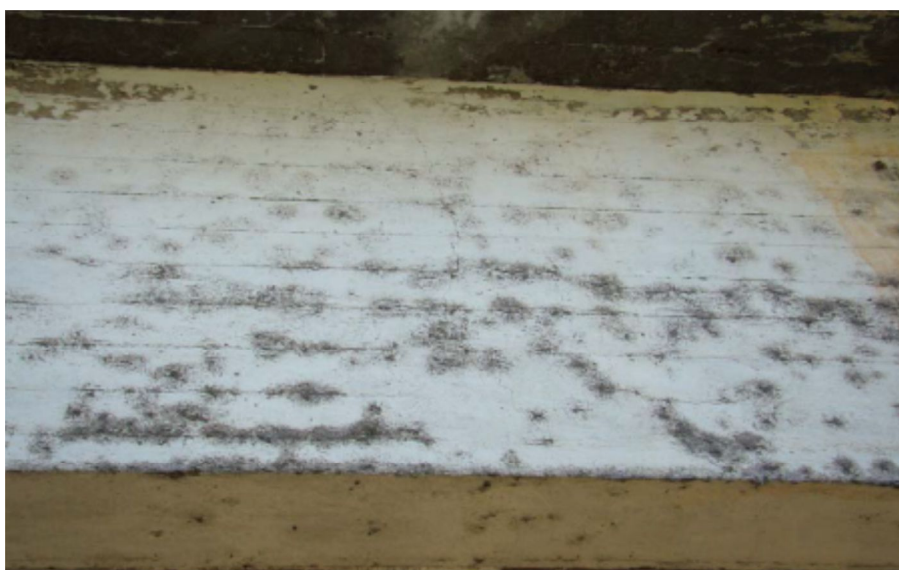
Foto 15 – Detalhe fissuras na primeira transversina entre pilar P1 e P2
