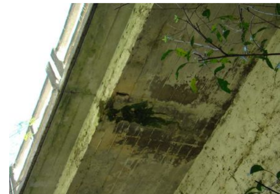
TRINCAS BALANÇOS DOS PASSEIOS NO ALINHAMENTO DO PORTICO P7 LADO ESQUERDO
