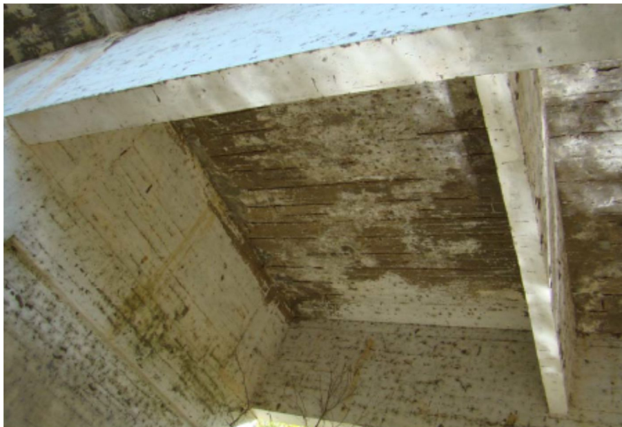
Foto 18 – Detalhe patologias – Vão E1 e P1
