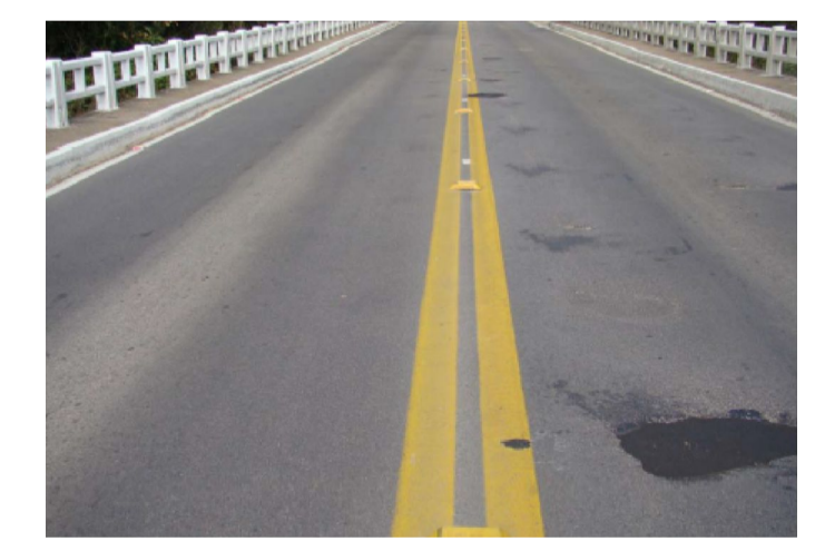
REFLEXO DAS PATOLOGIAS NAS ARMADURAS DA LAJE NA PAVIMENTAÇÃO ASFÁLTICA
