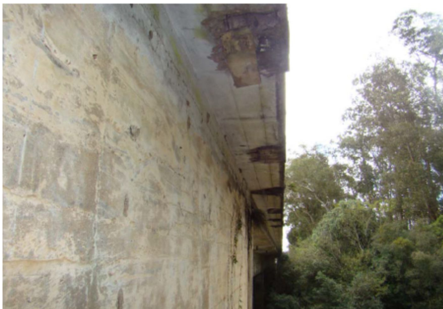
Foto 25 – Detalhe obstrução das pingadeiras
