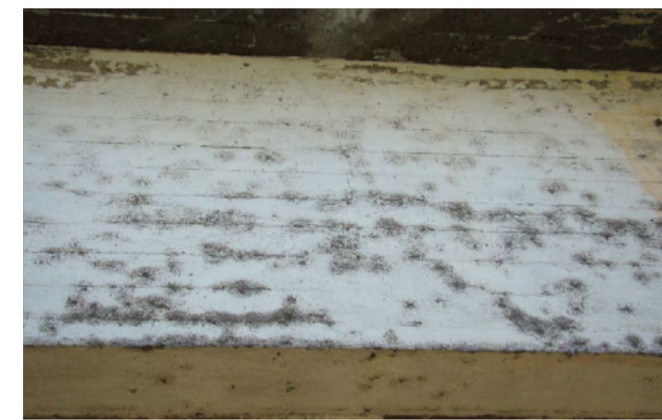
FISSURAS CARACTERÍSTICAS NAS TRANSVERSINAS
