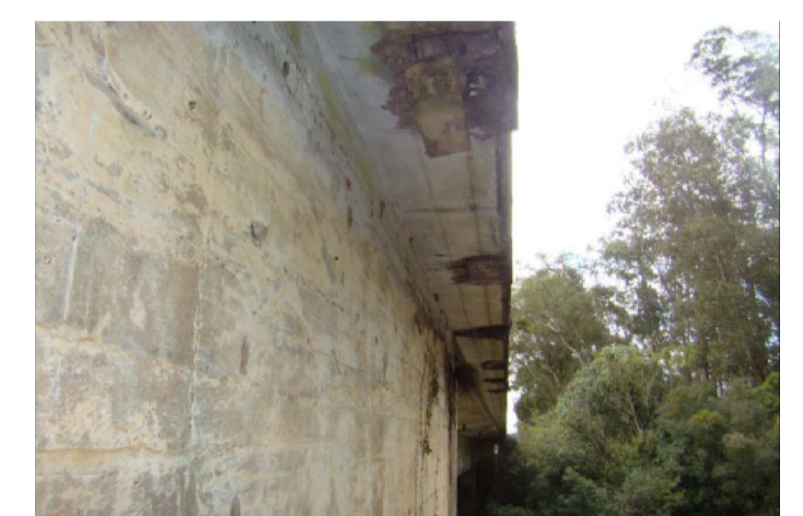
PINGADEIRAS OBRUIDAS POR SUBSTITUIÇÃO INADEQUADA DE GUARDA RODAS
