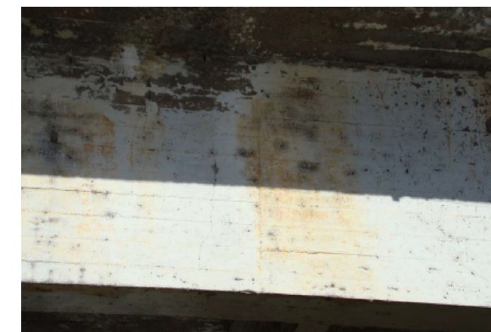
FISSURAS CARACTERÍSTICAS NAS LONGARINAS - LADO ESQUERDO VAP P2 - P3
