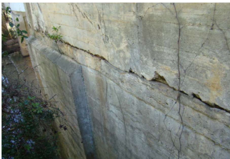
Foto 07 – Detalhe fratura na parede lateral do encontro – Lado Camaquã
