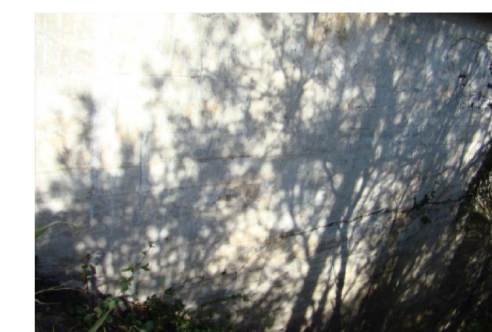
FRATURA NA PAREDE LATERAL DIREITA - LADO CAMAQUÁ
