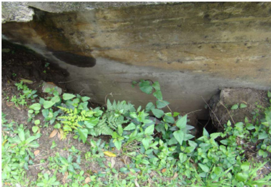
Foto 30 – Detalhe erosão junto a parede lateral esquerda – Encontro de Pelotas
